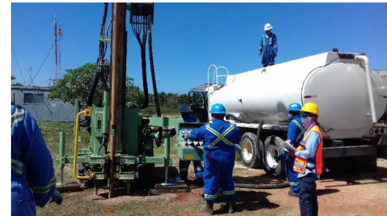
Fig. 3. Perforación de pozo de observación y ensayo de carga (Foto del autor)
