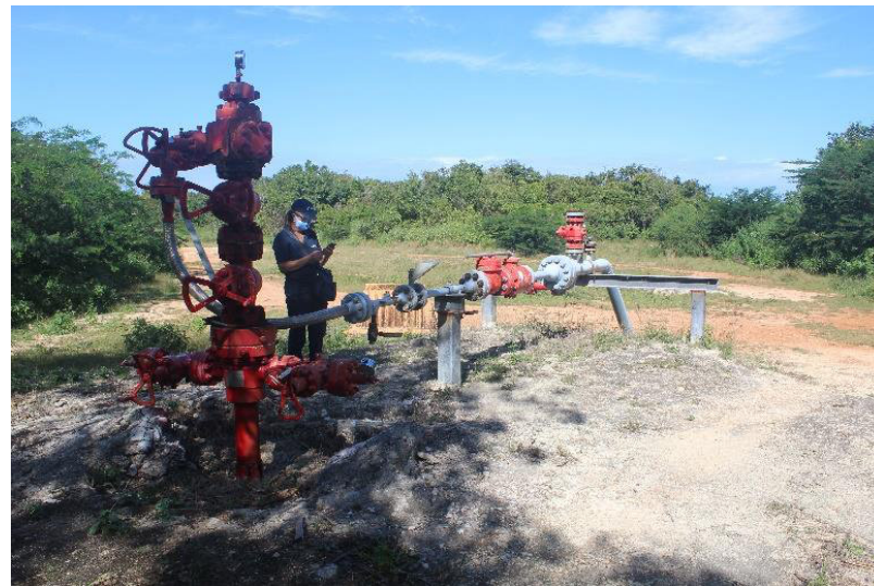
Fig. 2. Pozo productor abandonado en la Granja de Crudos Pesados del Norte de La Habana-Matanzas equipado para inyectar aguas producidas (Foto del autor).
